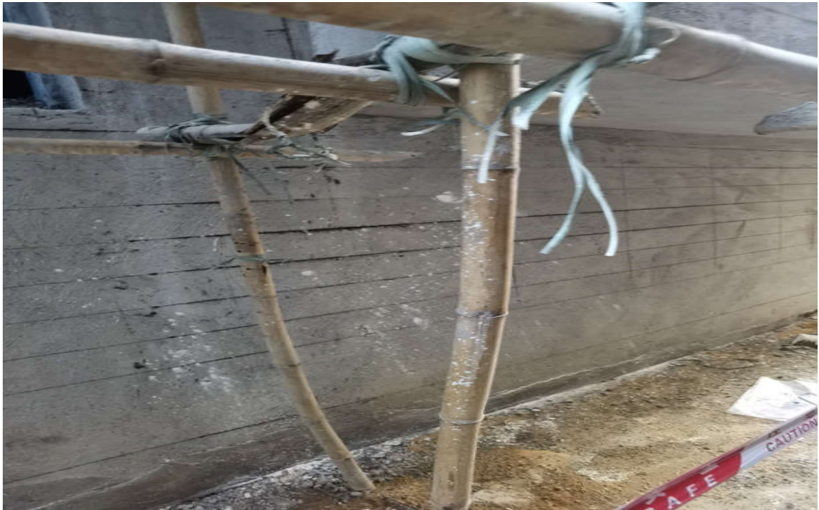
图注 1：事故坠落点小横杆已断，竹脚手架欠缺扫地杆
