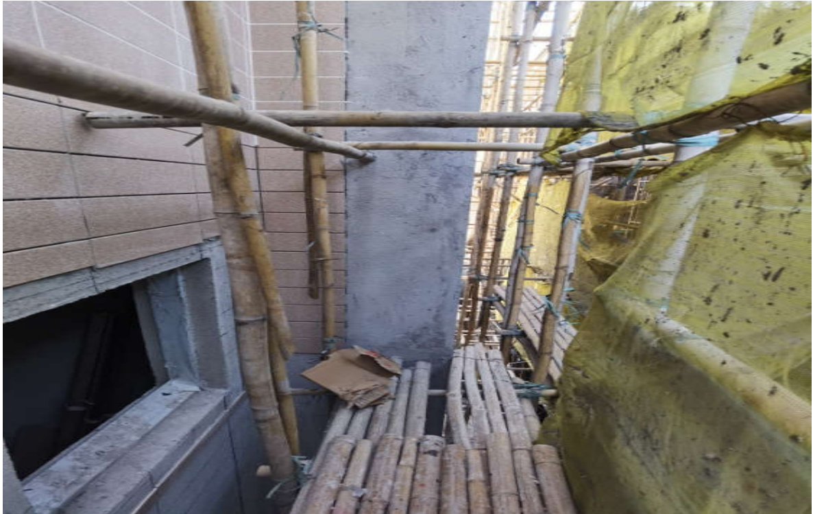
图注 3: 坠落后的工作面, 没有满铺脚手板, 只在工作层的作业面铺设少量脚手板, 脚手板没有绑扎固定在小横杆上
