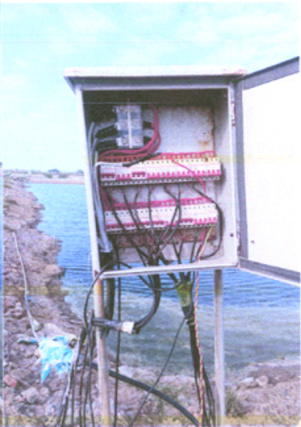
图 8 开关箱内部的情况
