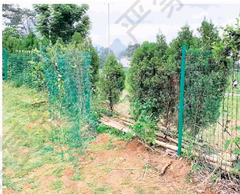
图 3.1-4 甘村水库西侧前置库原有隔离防护网破损实拍图
