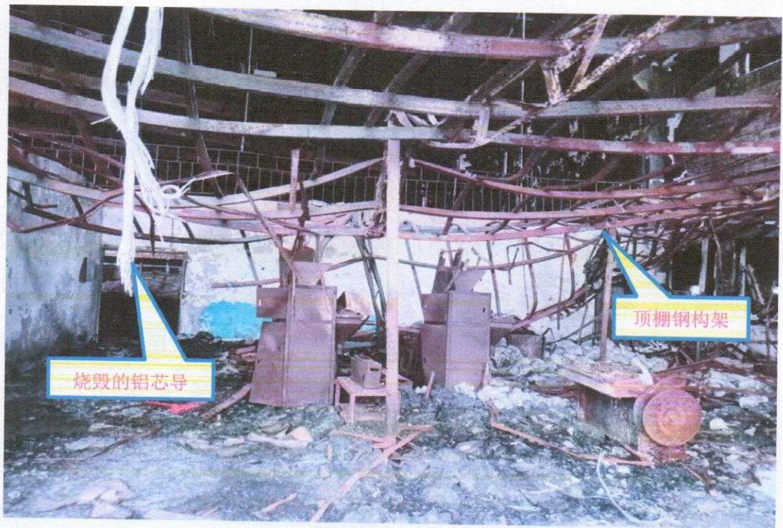
图 3 现场火灾情况
