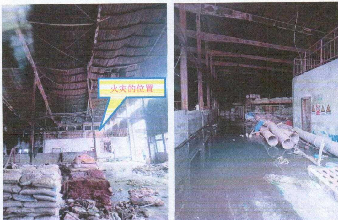
图 2 涉事车间内部的情况
