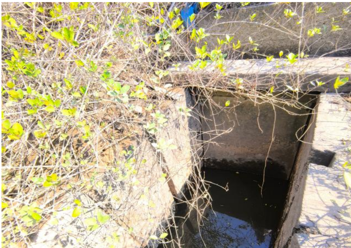
图 4.3-18 5#水闸（闸板损坏，腐蚀严重）
