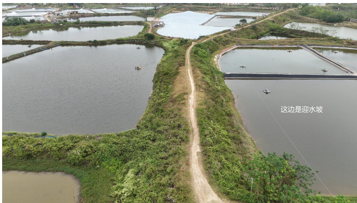
图 4.3-10 和平堤（现状堤顶路面未硬化、无防浪墙，部分堤身未修建砼护坡、背水坡水土流失严重）
