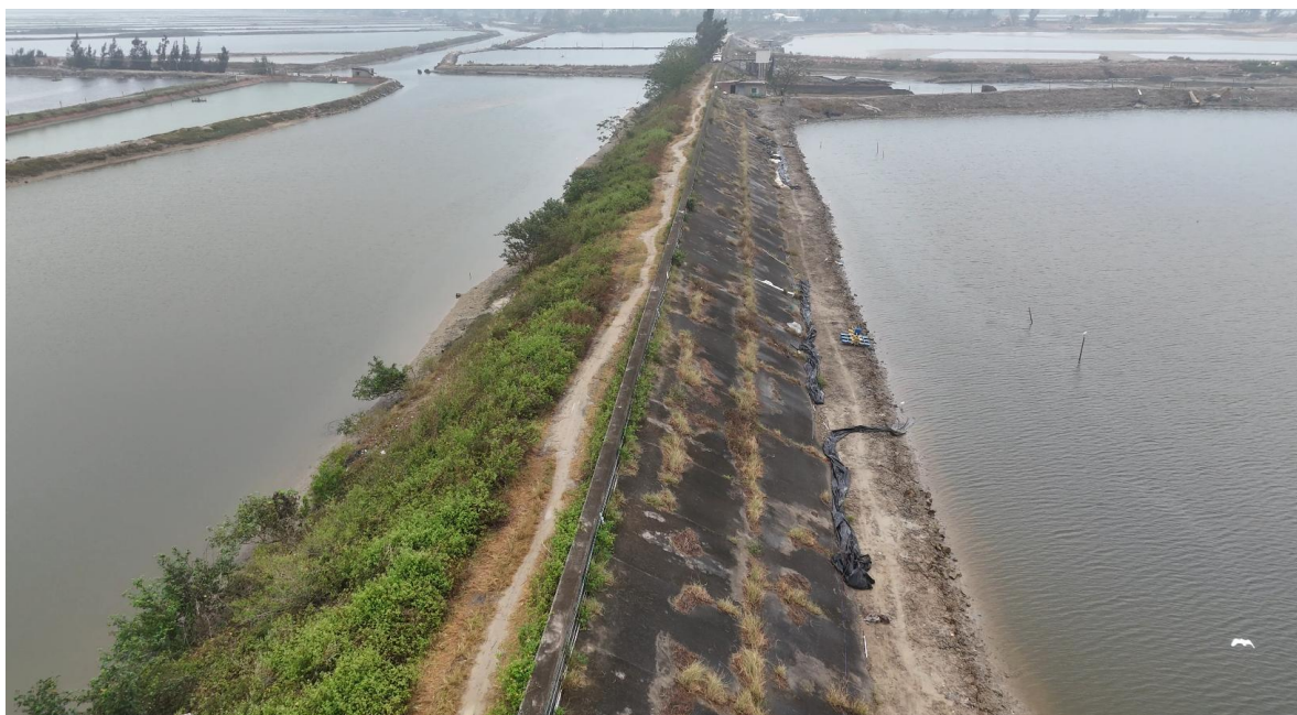
图 4.3-4 北灶堤（现状堤顶路面未硬化）
