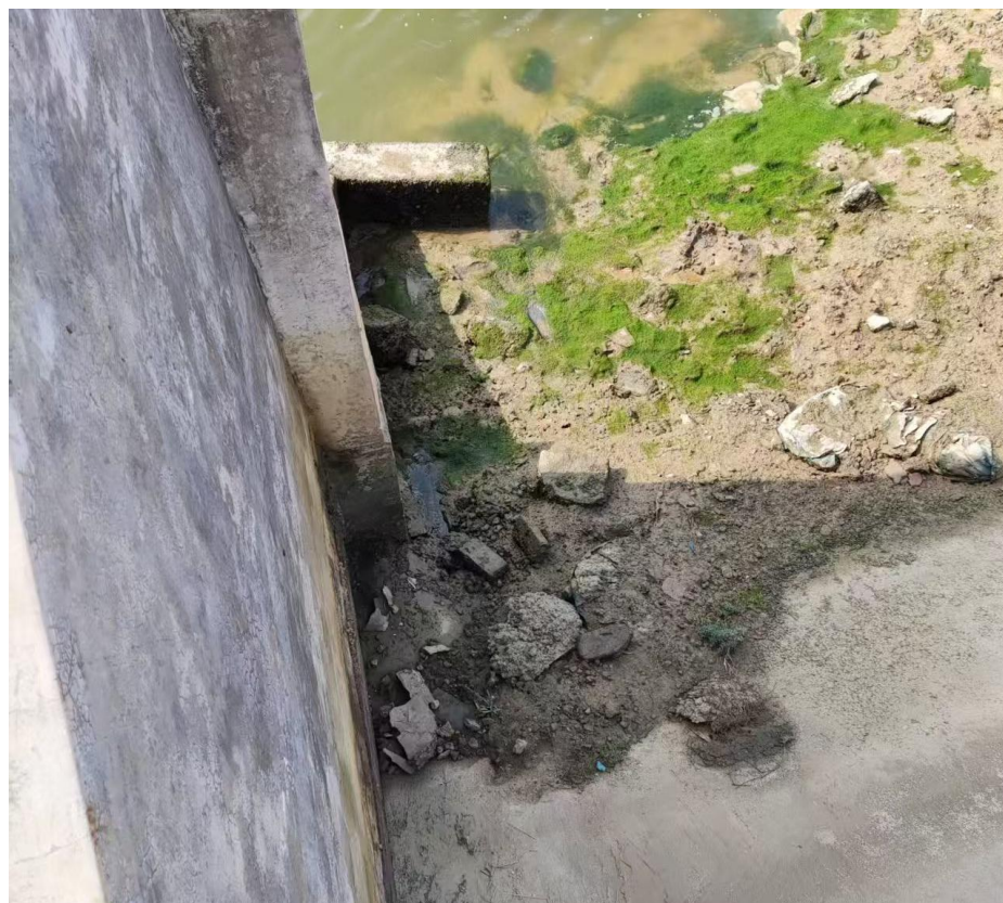
图 4.3- 27 47#水闸（水闸附近堤身渗漏）
