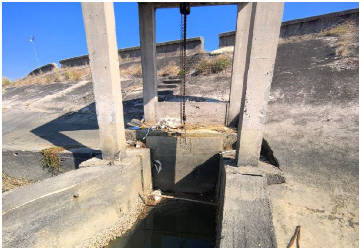
图 4.3-13 1A#水闸（附近迎水坡掏空）
