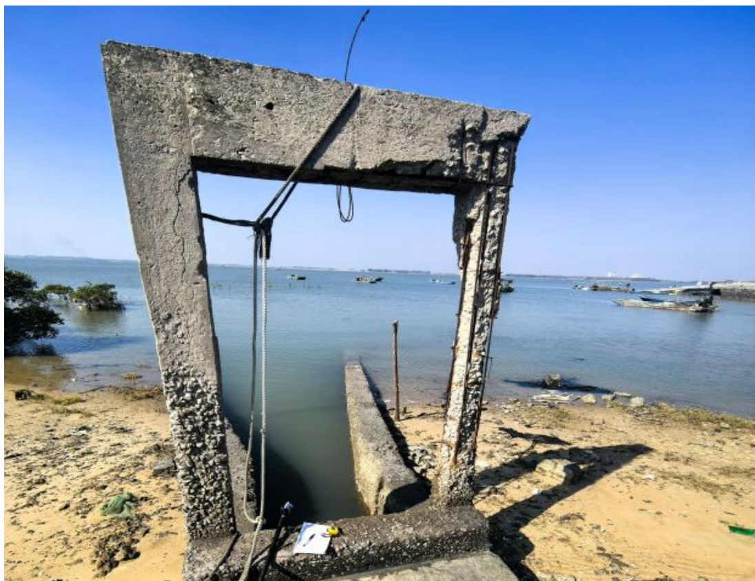
图 4.3-15 1C#水闸（闸板损坏，原启闭机架破损）
