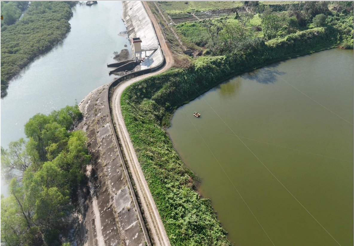
图 4.3-1 北头寮堤（现状堤顶路面未硬化，迎水坡有塌陷）
