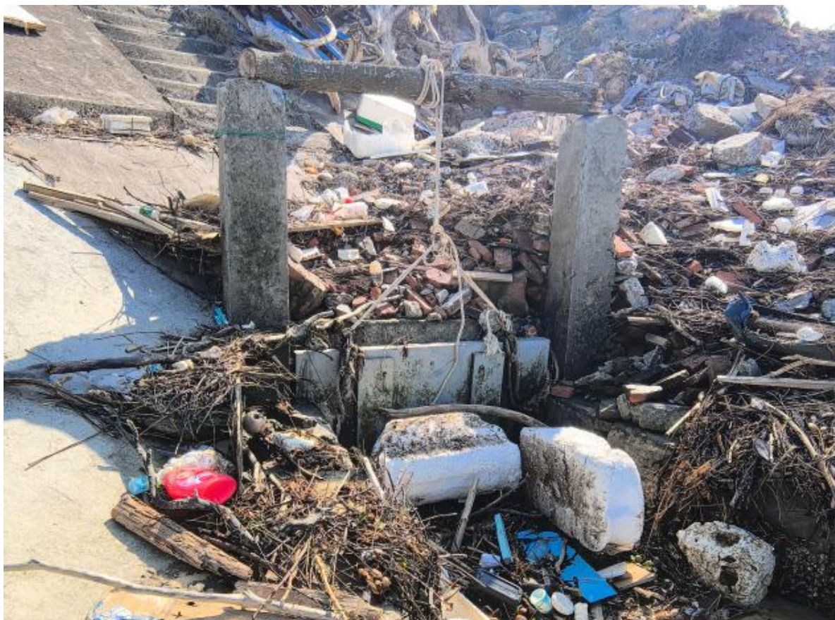
图 4.3-12 1#水闸（闸板损坏，原启闭机架破损）
