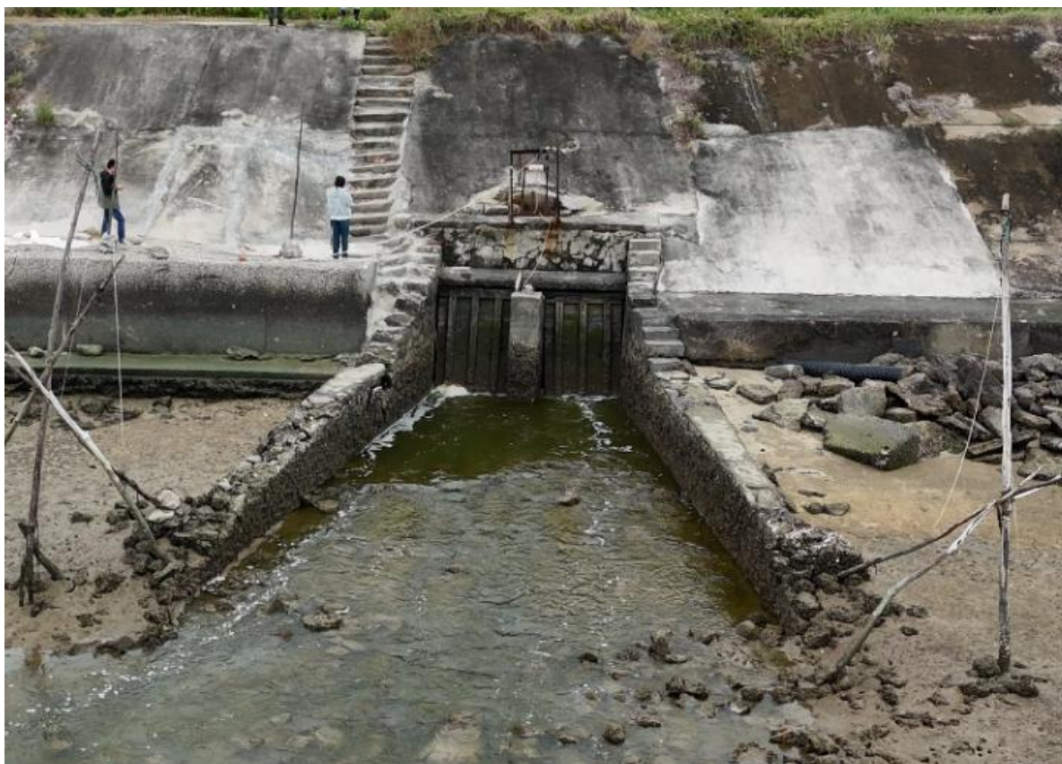
图 4.3- 28 62#水闸（堤身右侧塌陷，闸板渗漏）
