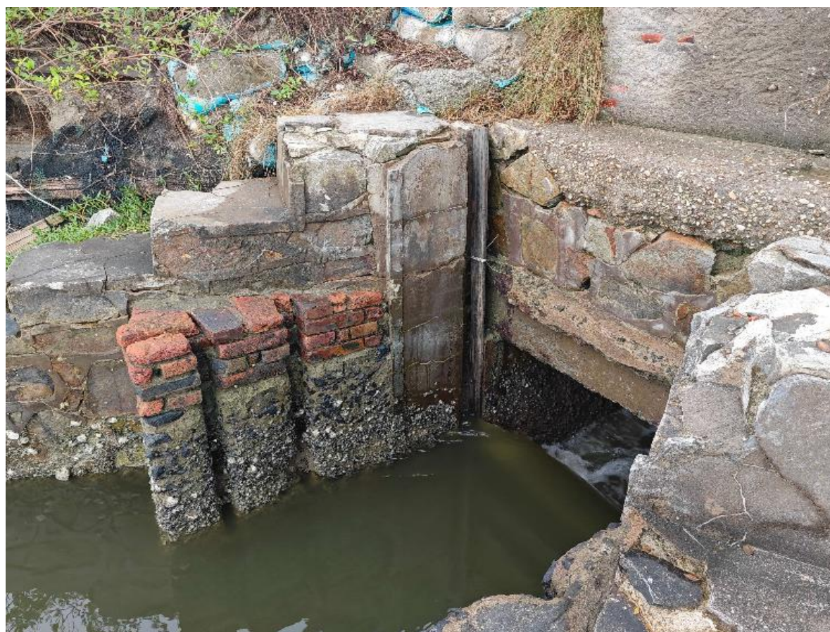
图 4.3-23 29#水闸（堤身渗漏、闸板漏水）
