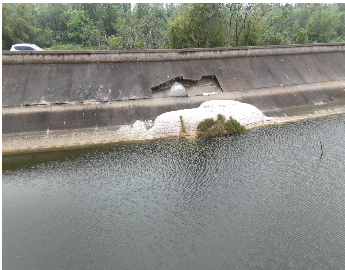
图 4.3-5 凤犁堤（迎水坡有开裂，堤顶路未硬化）
