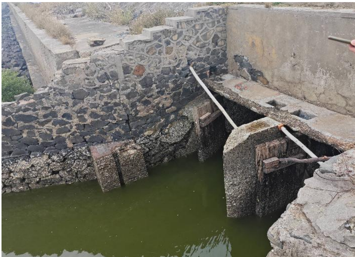
图 4.3- 26 41#水闸（闸门损坏、现状无启闭机）
