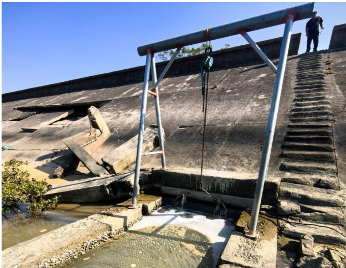
图 4.3-14 1B#水闸（闸板损坏，原启闭机架倒塌）
