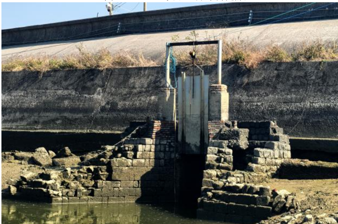
图 4.3-25 36#水闸（涵身底板破裂、翼墙损坏）
