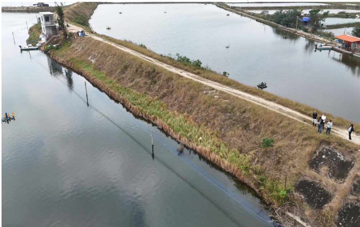
图 4.3-9 联合堤（现状堤顶路面未硬化、无防浪墙，部分堤身未修建砼护坡、背水坡水土流失严重）
