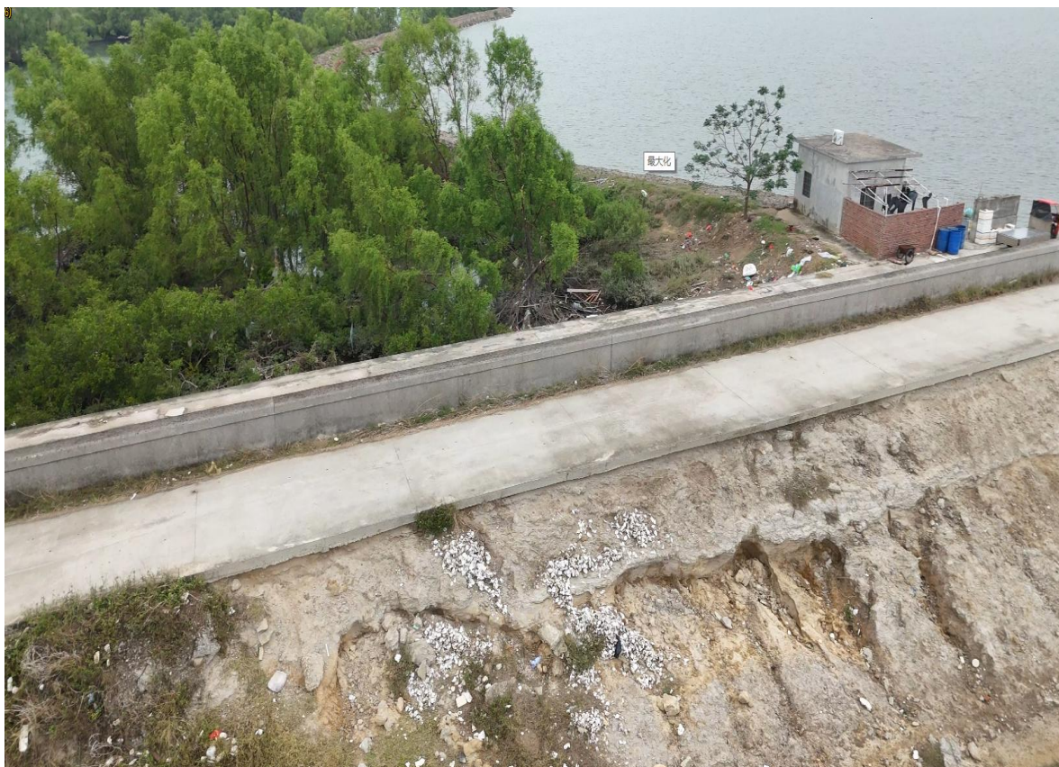
图 4.3-2 光明堤（背水坡水土流失严重）
