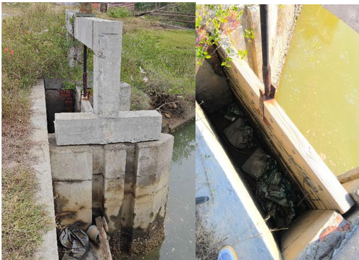
图 4.3-19 6#水闸（一侧闸孔损坏封堵）
