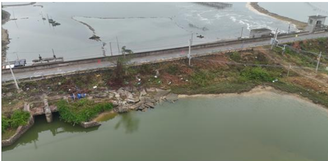
图 4.3-6 岭尾堤（背水坡掏空塌方）
