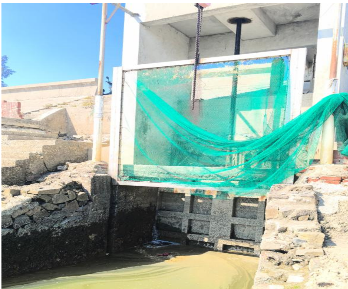
图 4.3-21 21#水闸（翼墙开裂）
