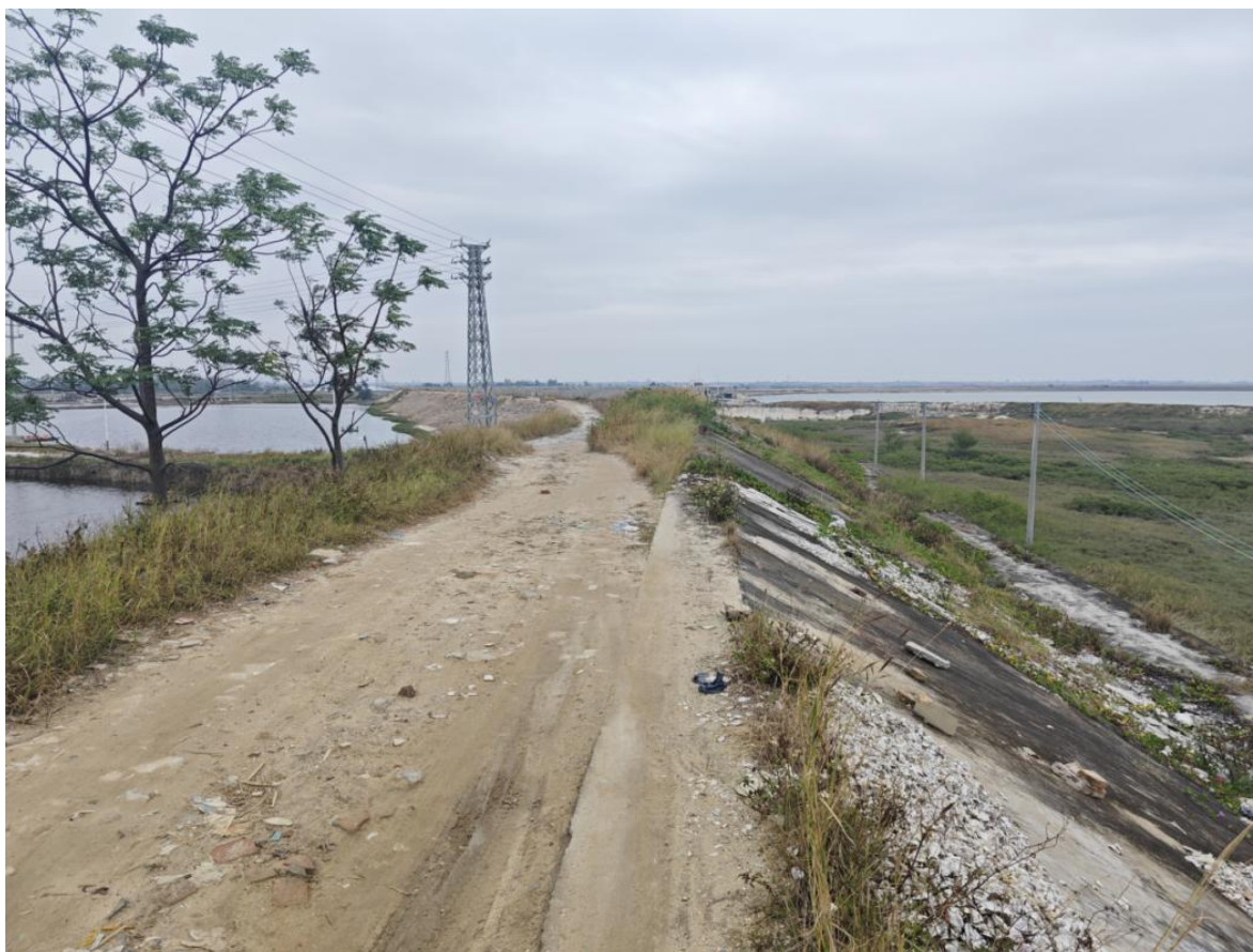
图 4.3-8 南海堤（现状堤顶路面未硬化、无防浪墙，背水坡水土流失严重）
