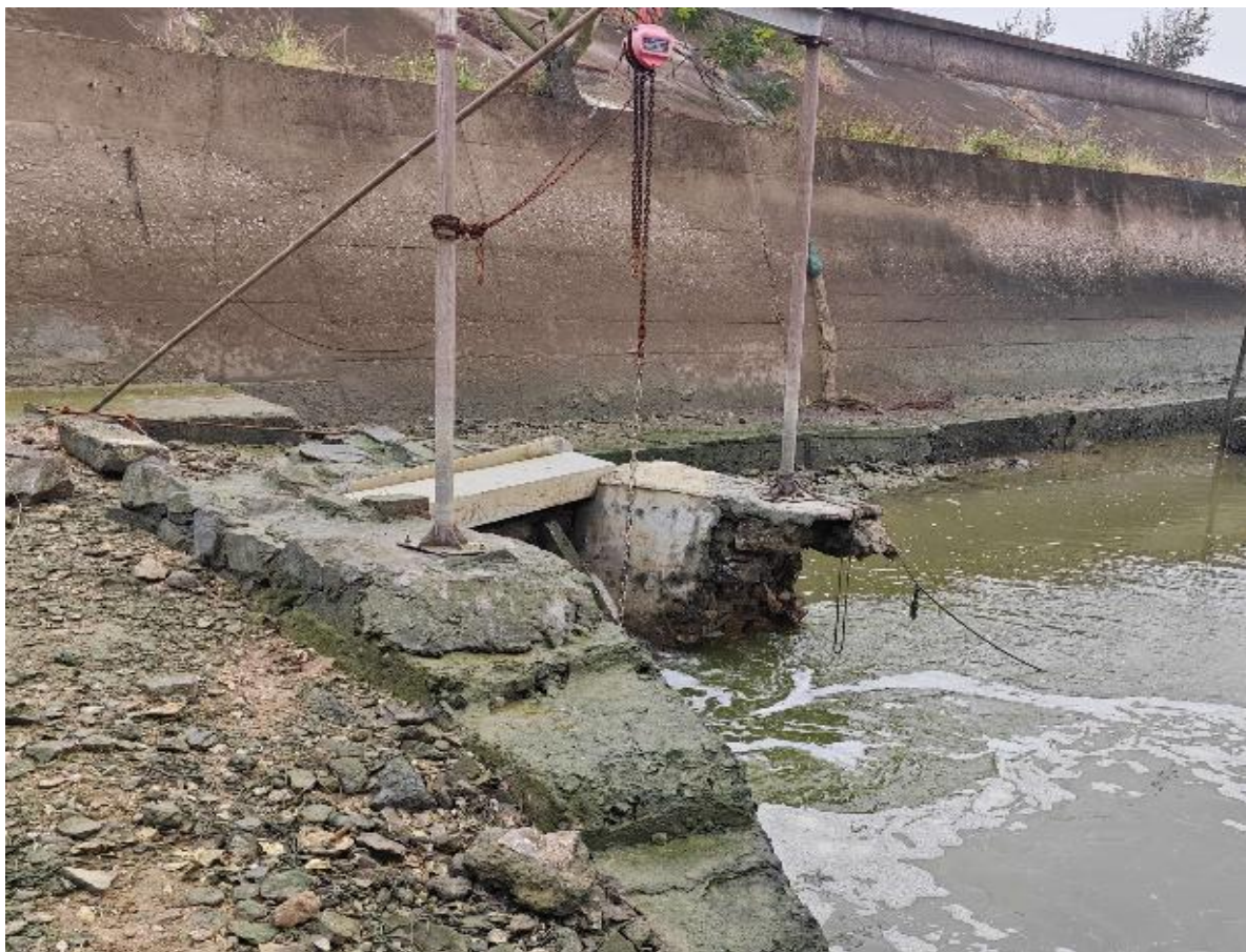
图 4.3-24 30#水闸（外江翼墙破损）
