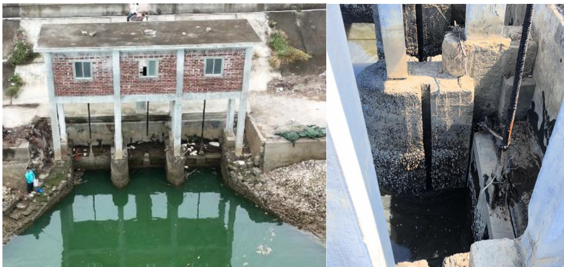
图 4.3-20 7#水闸（闸身存在裂缝）
