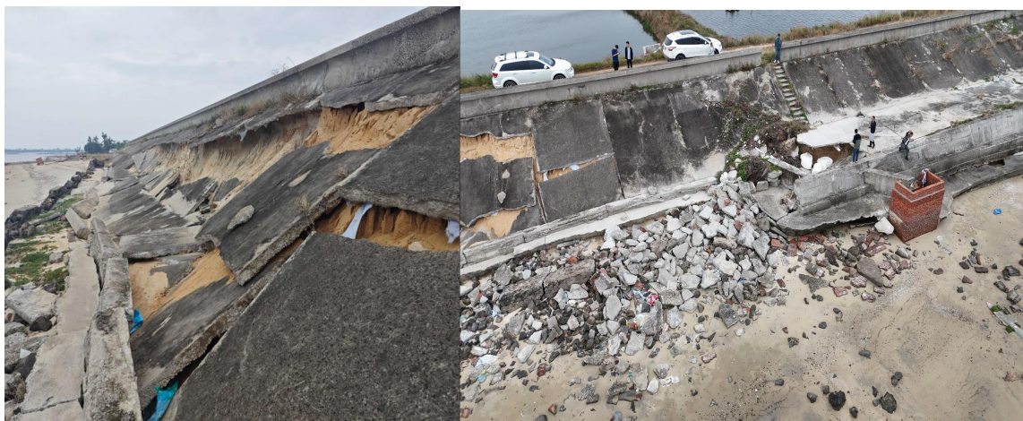
图 4.3-7 通沟堤（迎水坡塌陷，迎水坡平台多次出现险情，存在堤防缺口）
