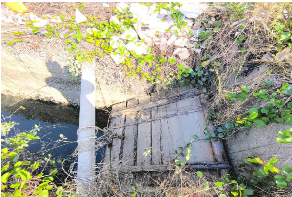
图 4.3-17 2#水闸（闸板损坏，外江右侧掏空）
