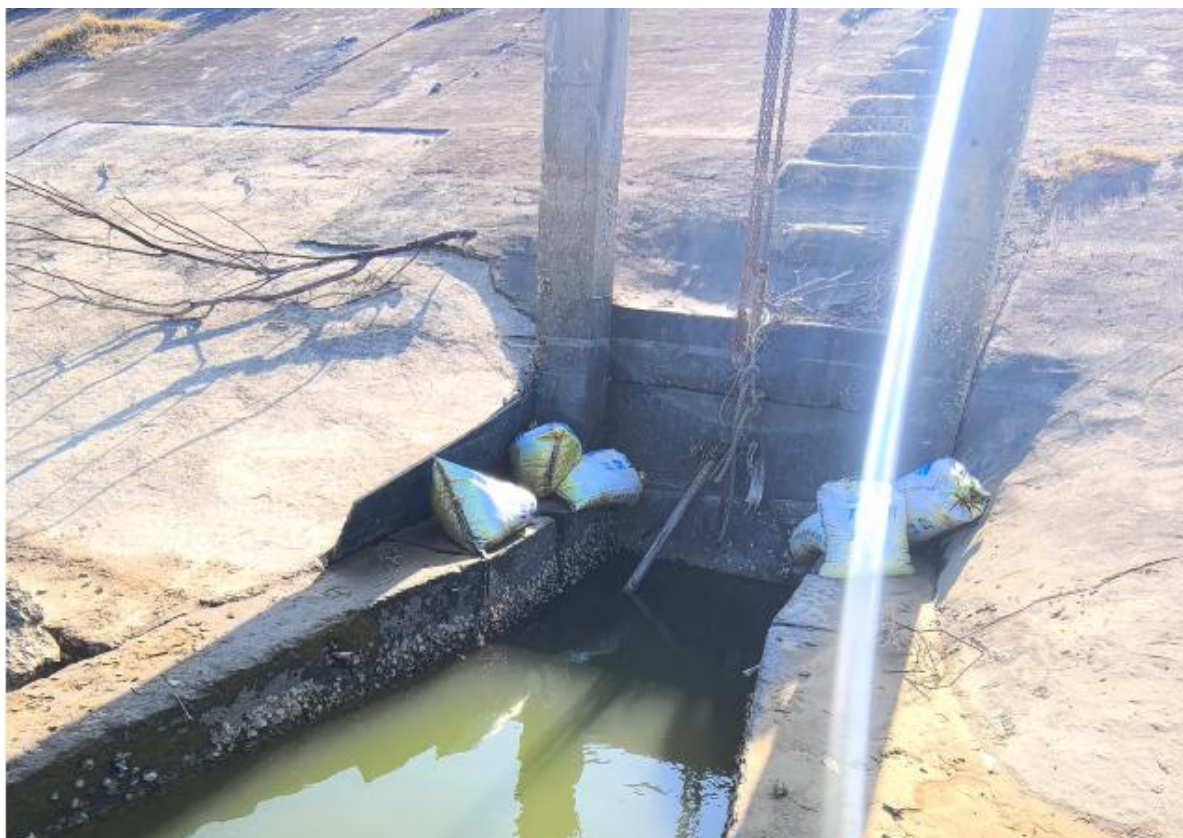
图 4.3-16 1F#水闸（现状闸板破损，左侧塌陷）
