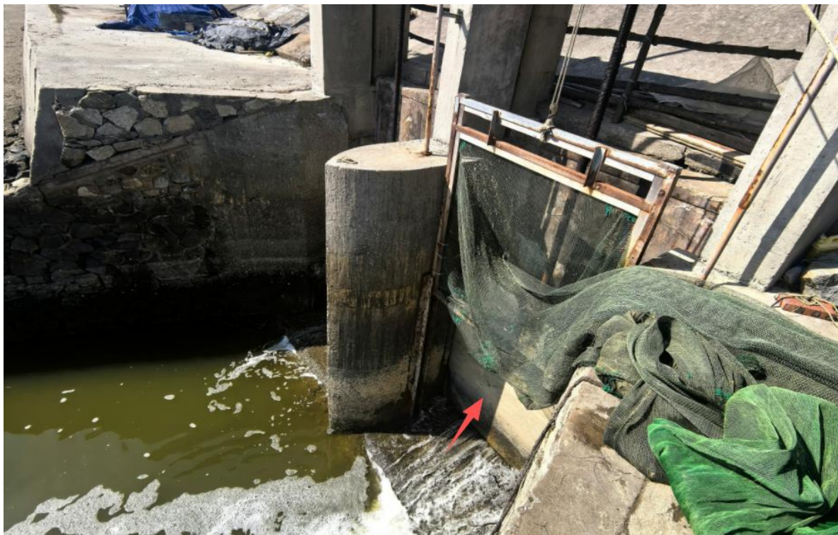
图 4.3-22 22#水闸（现状混凝土闸门破损）
