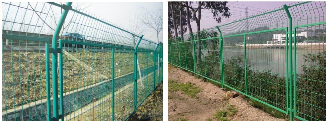
图 3.1-1 隔离网实物图
