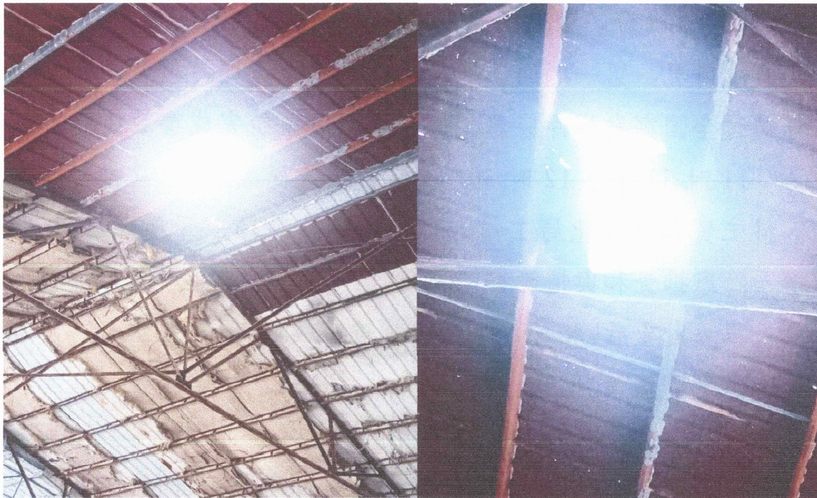
图 6 屋面破损孔洞情况
