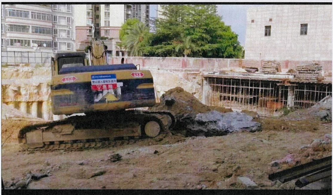
（我局附属房前水泥地台整块被挖掉）
