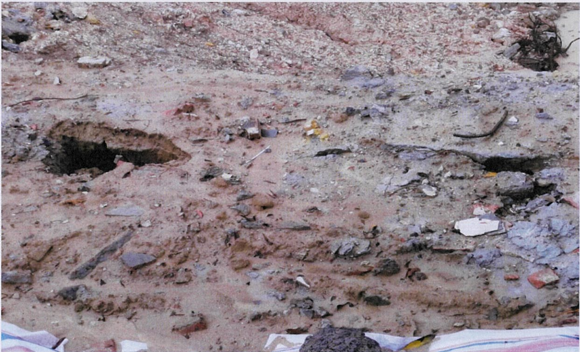
（只回填半边的泥土在下雨后出现下陷和空洞）
