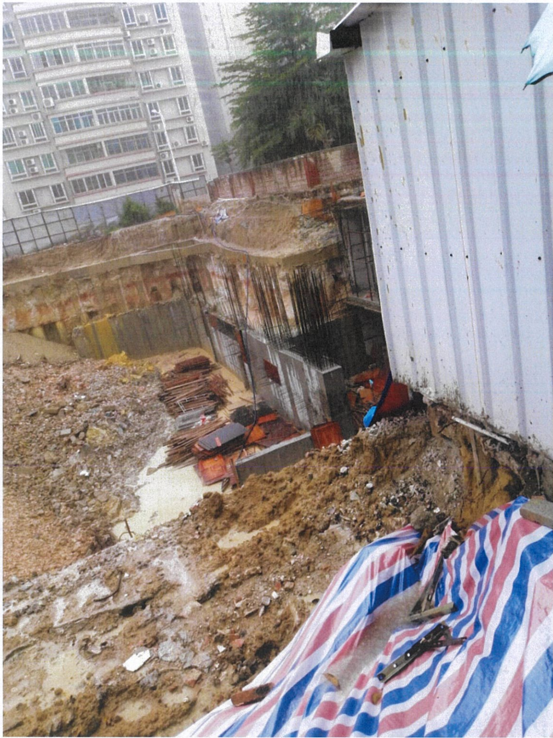
(我局附属房前水泥地台整块被挖掉后墙根空洞)
