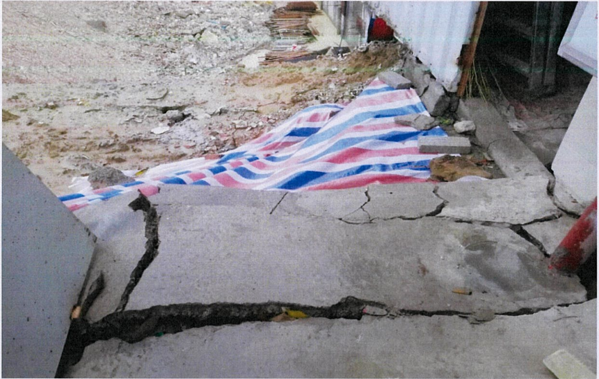
（食堂前平台继续下陷开裂）
